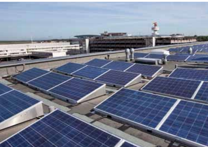
Solarenergie auf dem Dach des Verwaltungsgebäudes von Hamburg Airport
